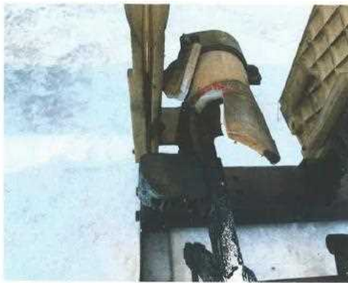
左（R相） 通常雪害や水分でのアーク放電 による損傷の場合ヒューズ上下 の金属部分が溶着すると思われ が、明らかにヒューズ内部より の衝撃による破損
