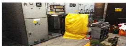
キュービクル外観
