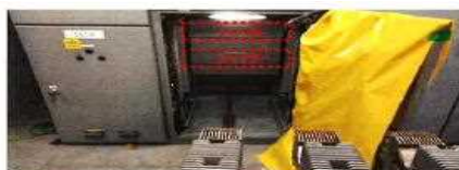
キュービクル内部
