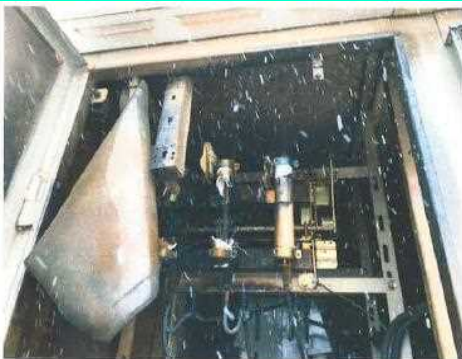
キュービクル損傷状況
